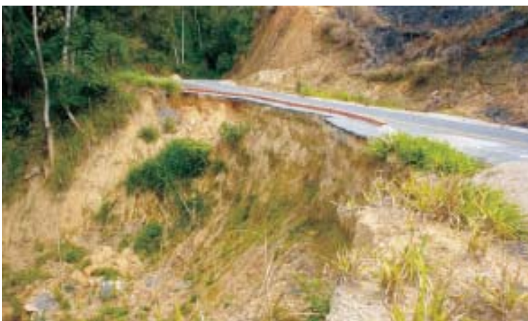
Figuras 14.154 e 14.155 – Processos erosivos decorrentes da exposição de solos residuais pouco evoluídos de granitos em talude de corte e utilizados na confecção de aterros (região do Vale do Ribeira, SP).
