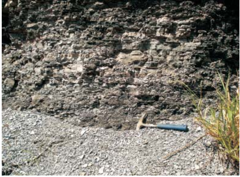
Figura 14.41 – Folhelho finamente laminado, que se desagrega e se desestabiliza com facilidade em taludes de corte (Formação Irati, SP).
