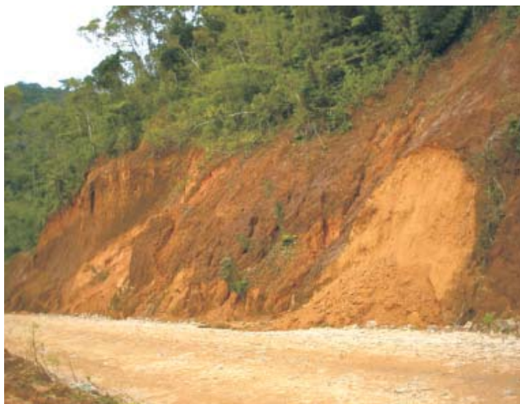
Figura 14.186 – Deslizamento em talude de corte nos terrenos gnaiss-migmatíticos, problema bastante freqüente na área de definição desse geossistema (município de Bocaiúva do Sul, PR).
