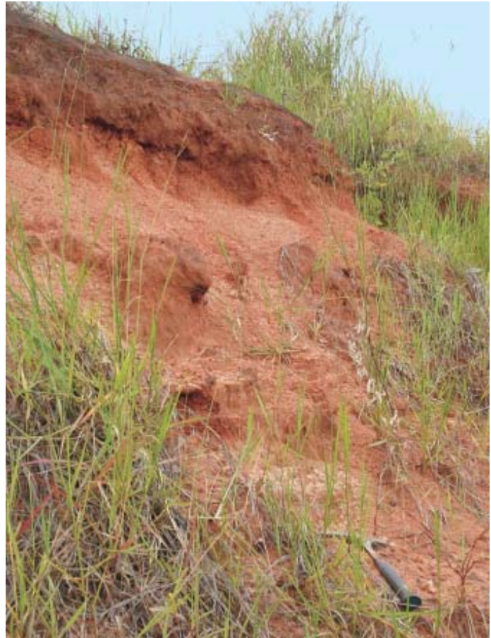
Figura 14.44 – Desestabilização em um talude de corte sustentado por sedimentos da Formação Santo Anastácio (SP).
