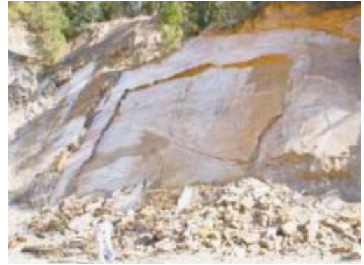
Figura 14.104 – Deslocamento em talude de corte de filitos do Grupo Açungui (região metropolitana de Curitiba, PR).
