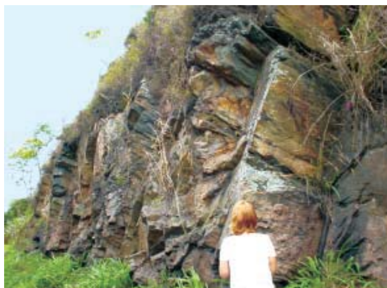
Figura 14.182 – Talude de corte da Rodovia Régis Bittencourt (SP), sustentado por rochas gnáissicas com duas proeminentes superfícies planares que facilitam o desprendimento de blocos.
