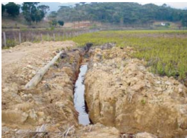
Figura 14.14 – Área com lençol freático aflorante ou situado próximo à superfície.
